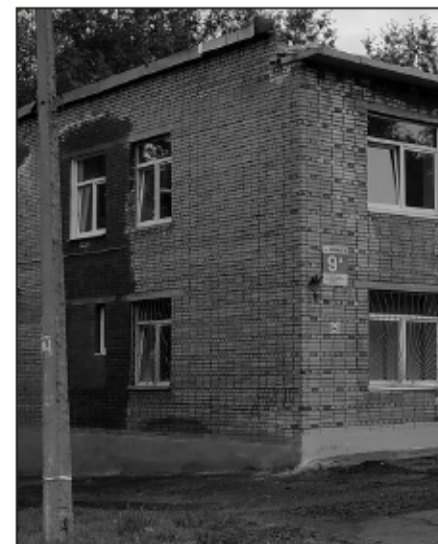
После июльских ливней второй этаж здания «промок» целиком.
