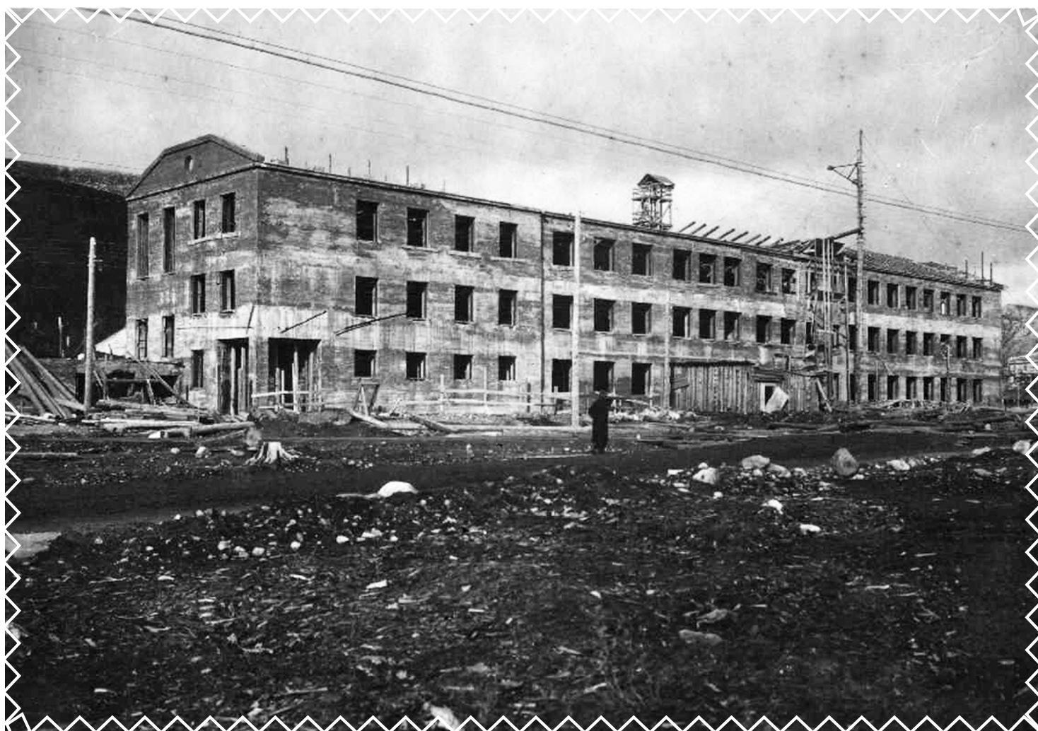
На смену баракам для школ довольно быстро начали строить каменные здания. На фото — строительство школы № 1. 1932 год
