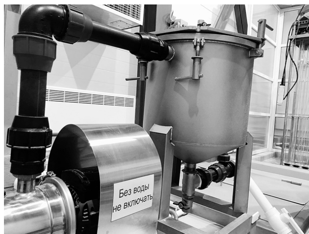
На новой станции УФ-обеззараживания стоков «Апатитыводоканала»
