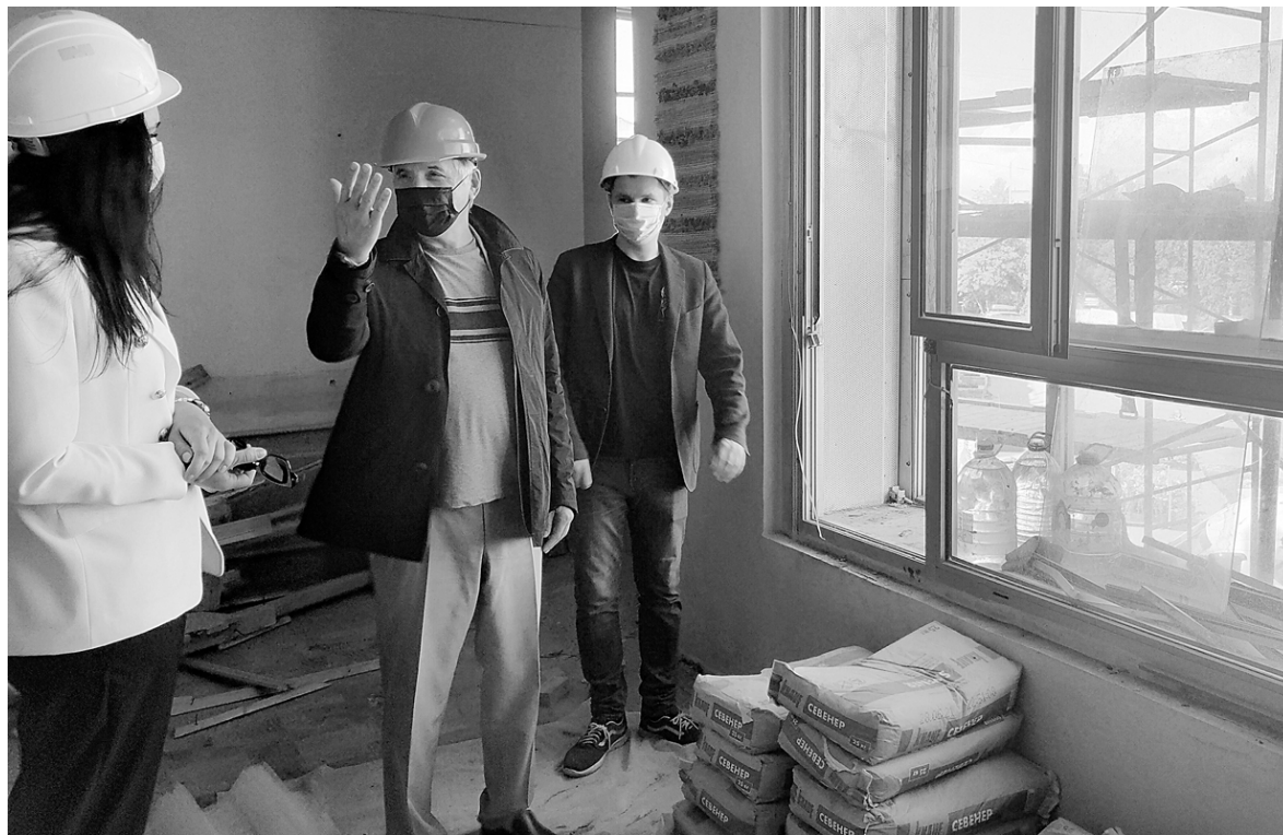
Ремонт библиотеки-музея требует особого внимания местных властей, это здание очень важно для апатитчан
